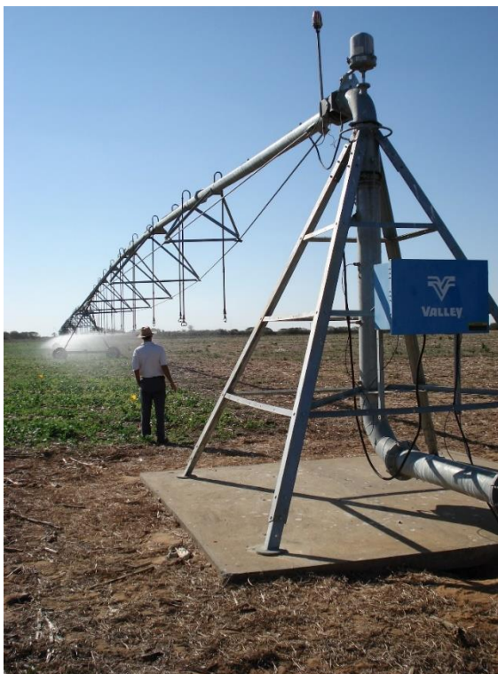
Figura 11. Torre central do pivô central.
