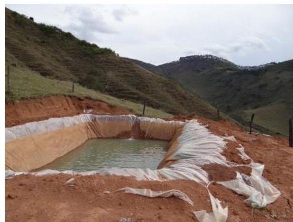
Reservatório para atender ao sistema de irrigação de pastagem da propriedade de Ladir Pinto Azevedo
