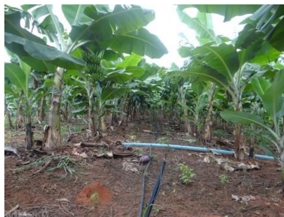
Sistema de irrigação por microaspersão em banana, avaliado na propriedade de Francisco de Assis da Silva
